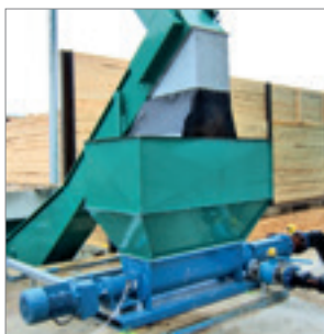
Alimentación continua de la bomba mediante una tolva de transferencia
