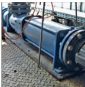
Convoyage de substrat entre les digesteurs
